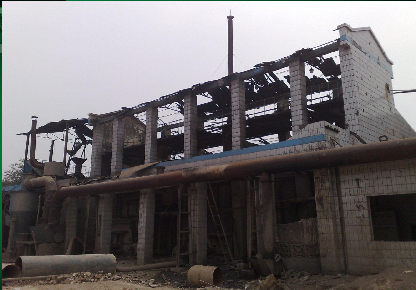
河南洛阳“7.15”爆炸事故现场
