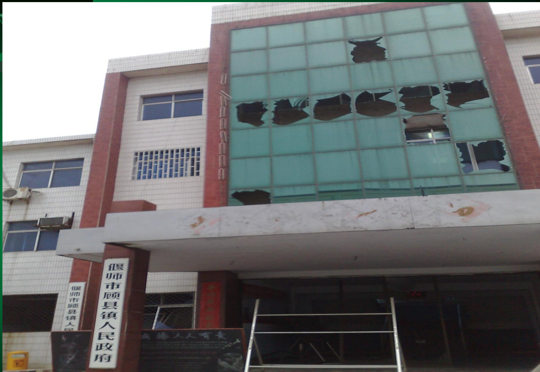
河南洛阳“7.15”爆炸事故现场
