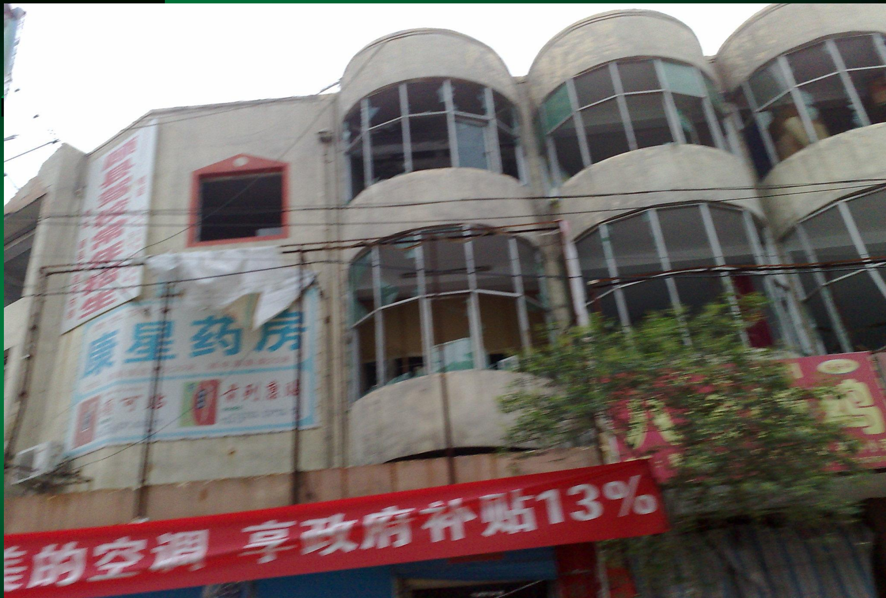
河南洛阳“7.15”爆炸事故现场
